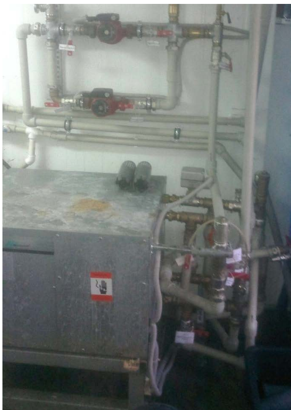
Рис. 59. Тепловой насос на мобильной рыбководной лаборатории
